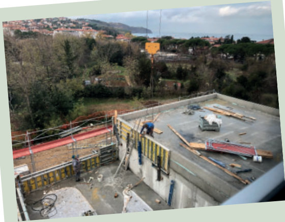
Execution of concrete ceilings for ground floor laboratories Izvedba betonskih stropov pritličnih laboratorijev
